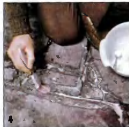
4 Трещины глубиной более 1 см перед нанесением самовыравнивающегося раствора заполняют цементным раствором, предварительно обработав их грунтовкой.
